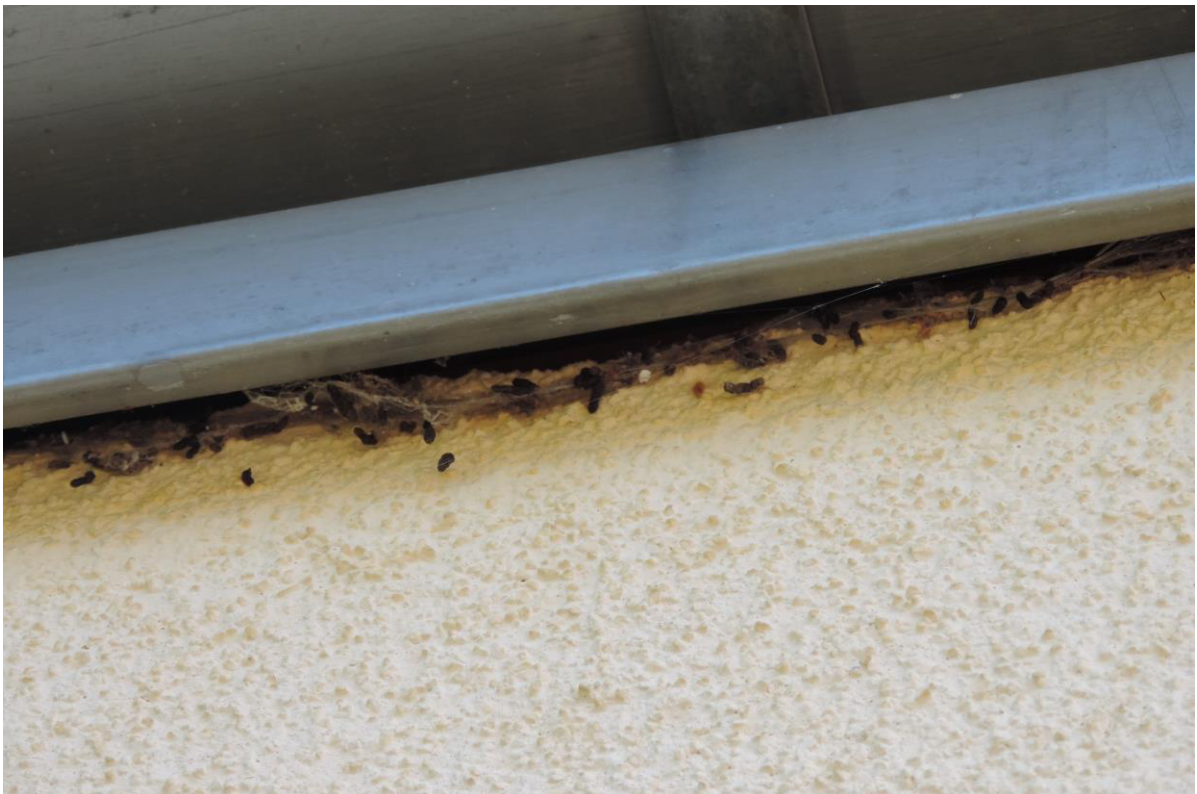
Abbildung 10: Frischer, kleiner bis mittelgroßer Fledermauskot am Südgebäude, der auf ein Sommerquartier von mehreren Tieren hinweist
